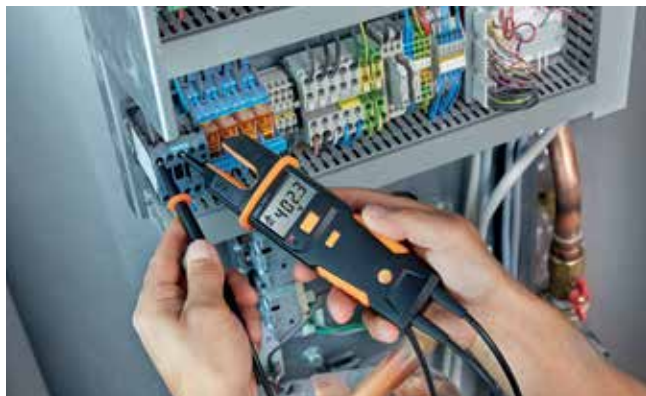
Проверка напряжения на тепловом насосе с testo 755 .
