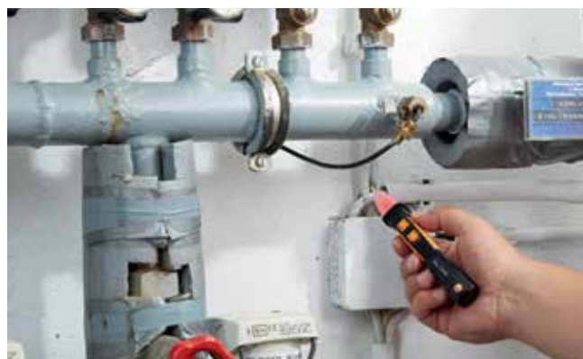
Проверка напряжения в распаечной коробке с testo 745 .
