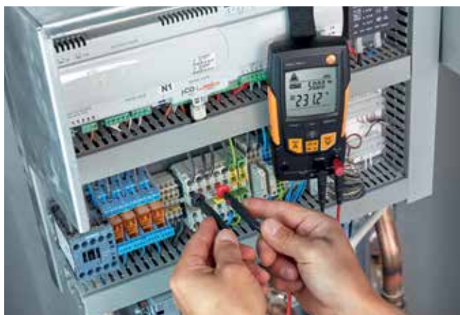
Проверка напряжения в распределительном щитке теплового насоса.
