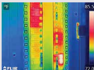
Щит с выключателями
