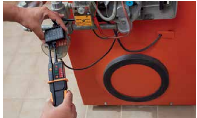
Обнаружение ошибок в работе отопительной системы с testo 750 .
