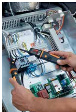
Измерение напряжения на компрессоре.
