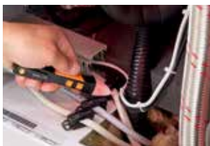
Первый тест подачи напряжения на компрессоре
