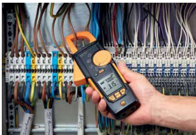
Измерение силы тока в распределительном щитке.
