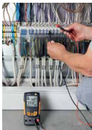
Проверка напряжения в распределительном щитке.
