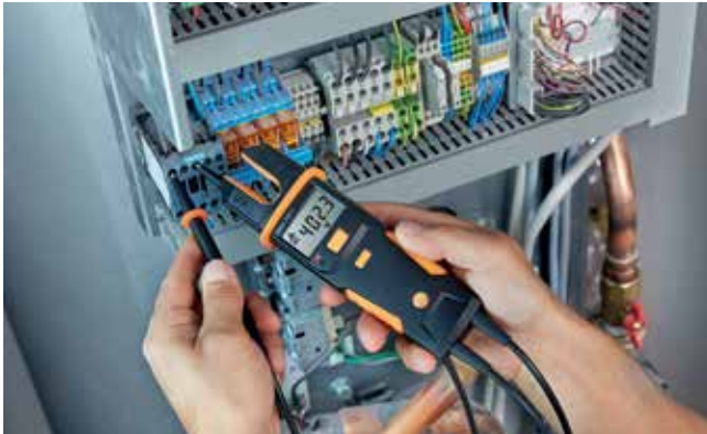
Проверка напряжения на тепловом насосе с testo 755 .
