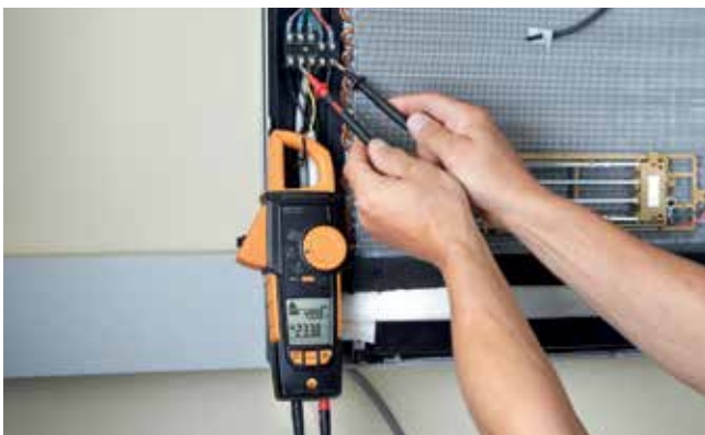
Измерение напряжения на блоке кондиционера с testo 770 .
